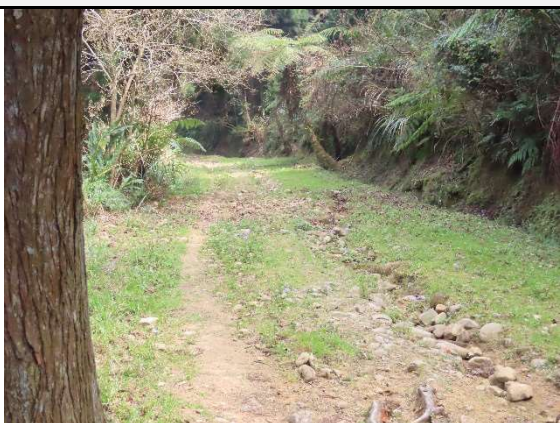
大湍林道土石路面
