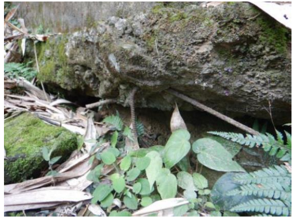
設施基礎掏空
