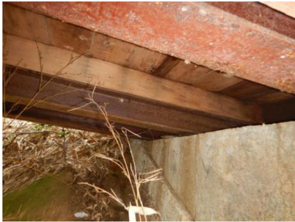
跨越橋鋼構生鏽
