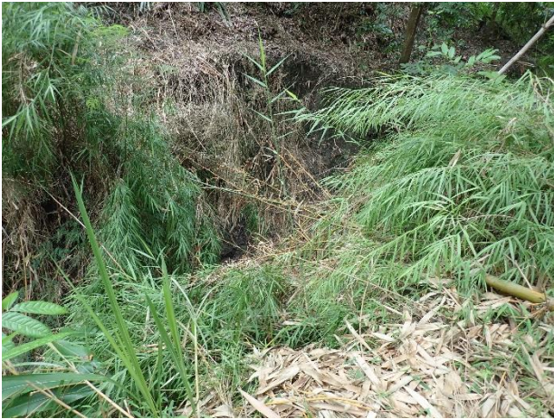
▲蝕溝沖刷情形
