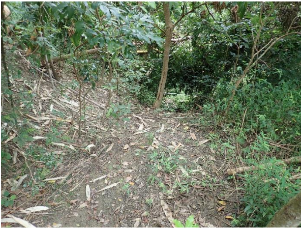
▲排水造成坡面沖蝕
