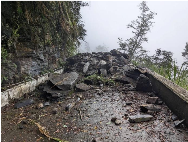
林道 10K+450 處有崩落石損壞路面及護欄
