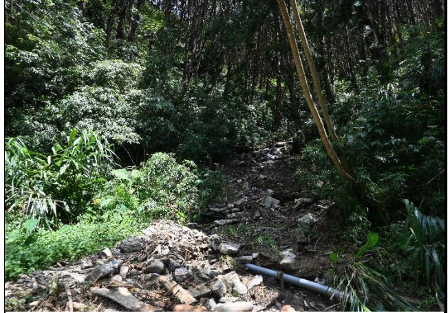
林道 12K 處雨水匯流無排水設施
