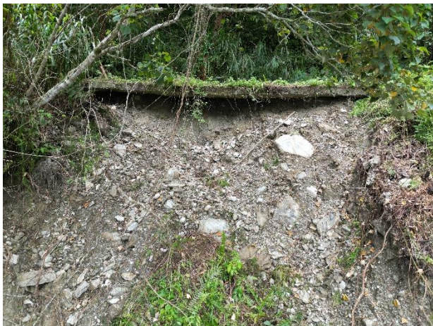
林道 19K 路基掏空
