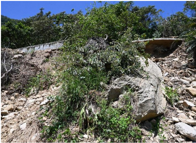
林道 2K 上邊坡土石崩塌
