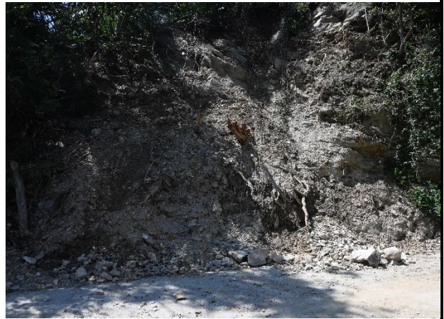
林道 5K 上邊坡土石崩塌
