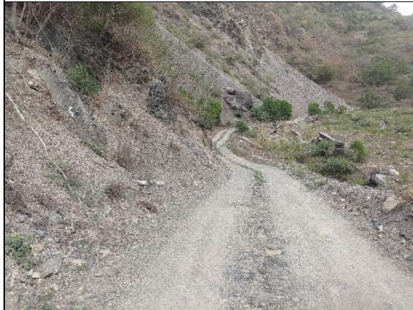
▲道路上邊坡岩屑崩落及凹岸侵蝕
