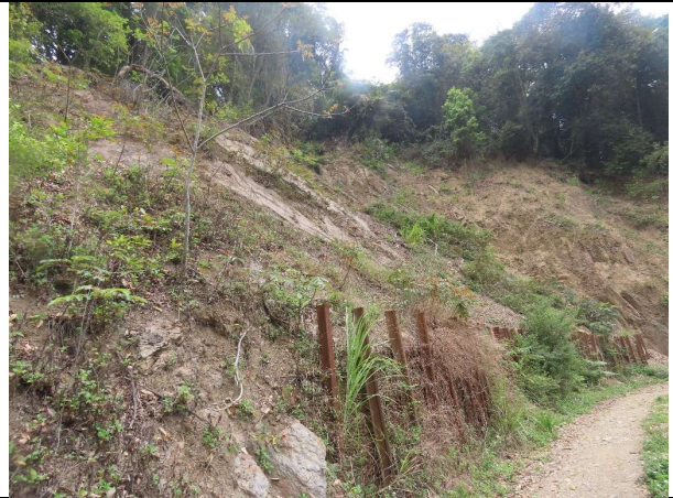
2K 崩塌坡面
