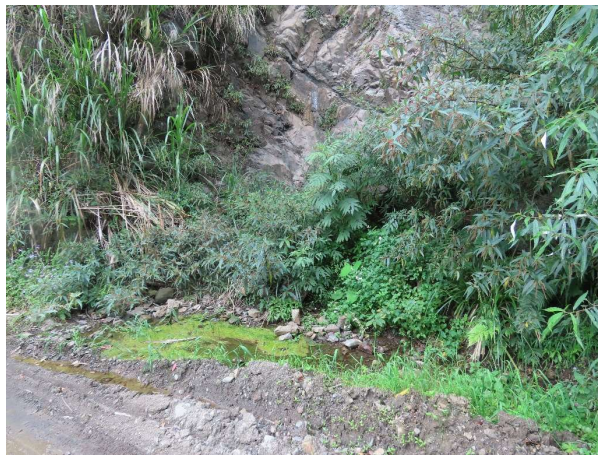
0K+780 上邊坡滲水
