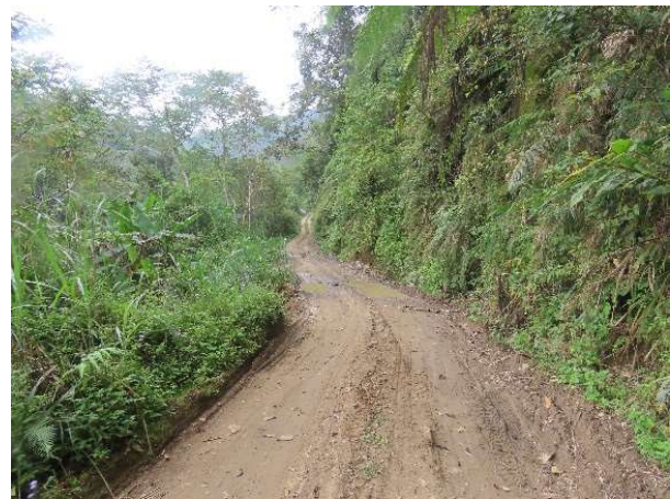
0K+965~1K+040 上邊坡滲水
